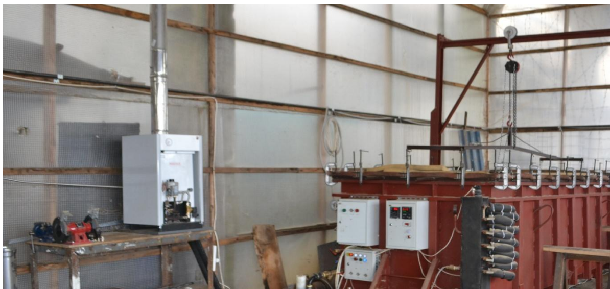
Рис.2. Камера «Энергия ПВ2». Нагрев от газового котла.
