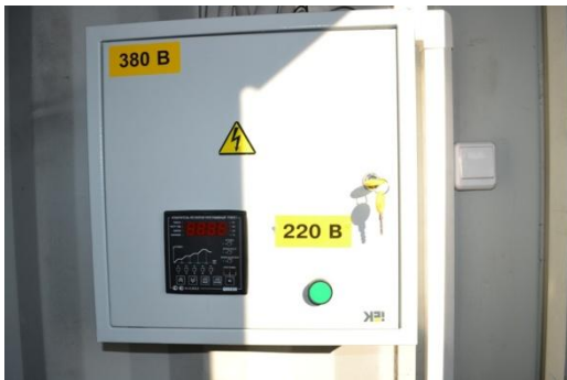
Рис. 3. Шкаф управления. Общий вид
